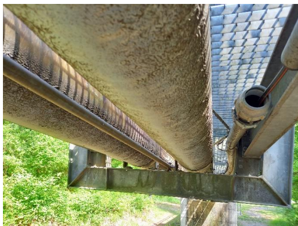
Figura 4: Condotte sotto la passerella (acqua potabile, acque luride e cavo di comando)
