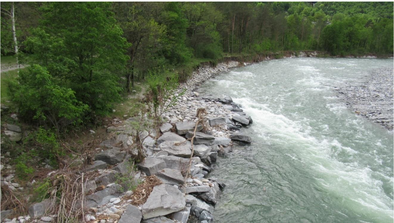
Figura 14: Erosione in sponda destra, vista verso monte (immagine del 12.05.2021)
