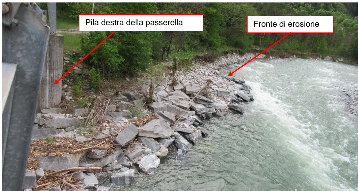
Figura 2: Stato dell'erosione in sponda destra, vista verso monte (immagine del 12.05.2021)
